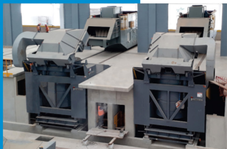
Carregamento de Forno com Exaustão
