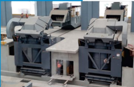
Carregamento de Forno com Exaustão
