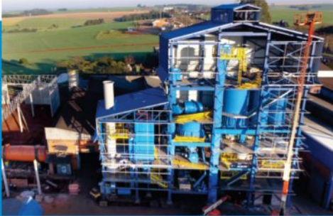
Preparação e Recuperação de Areia
