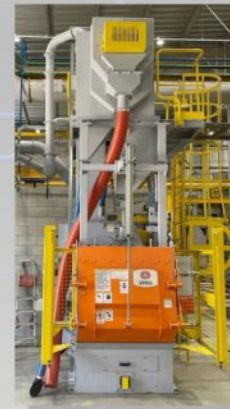
Equipamento instalado em nossa Fundição de Atibaia - SP
