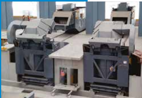
Carregamento de Forno com Exaustão
