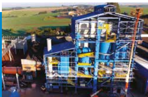
Preparação e Recuperação de Areia
