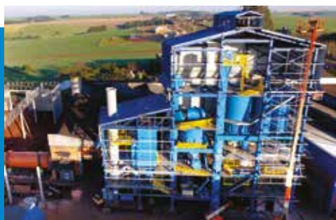
Preparação e Recuperação de Areia
