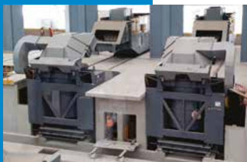
Carregamento de Forno com Exaustão
