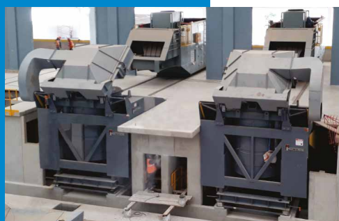
Carregamento de Forno com Exaustão
