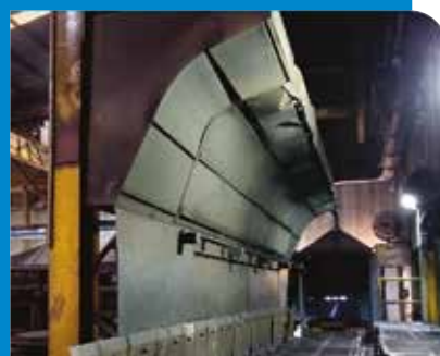
Linha de vazamento e resfriamento
