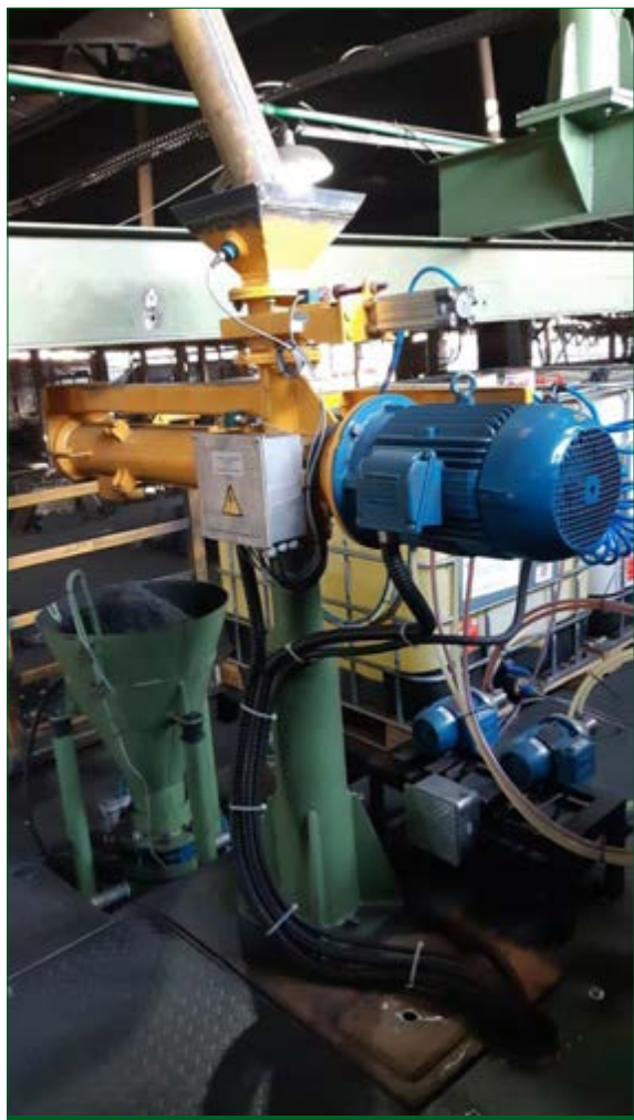
Misturador contínuo MSP instalado na Fundição Nacional
